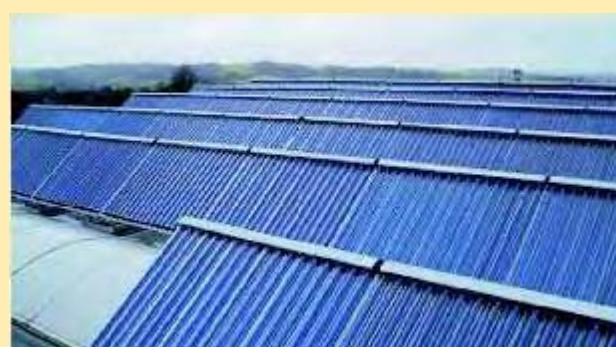
Obr. 3: Vakuové trubicové kolektory (400 m 2 ) na střeše firmy Steinbach & Vollmann, v Heiligenhausu, Německo.
