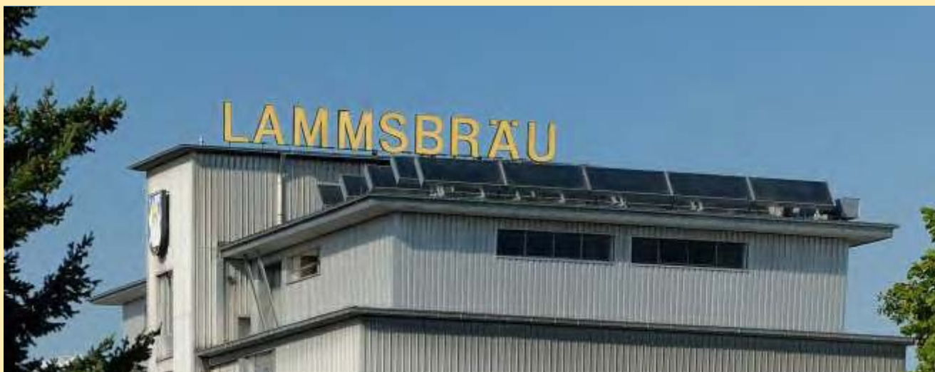
Obr. 4: Ploché teplovzdušné kolektory na střeše firmy (ventilační potrubí teplého vzduchu je vpravo).
